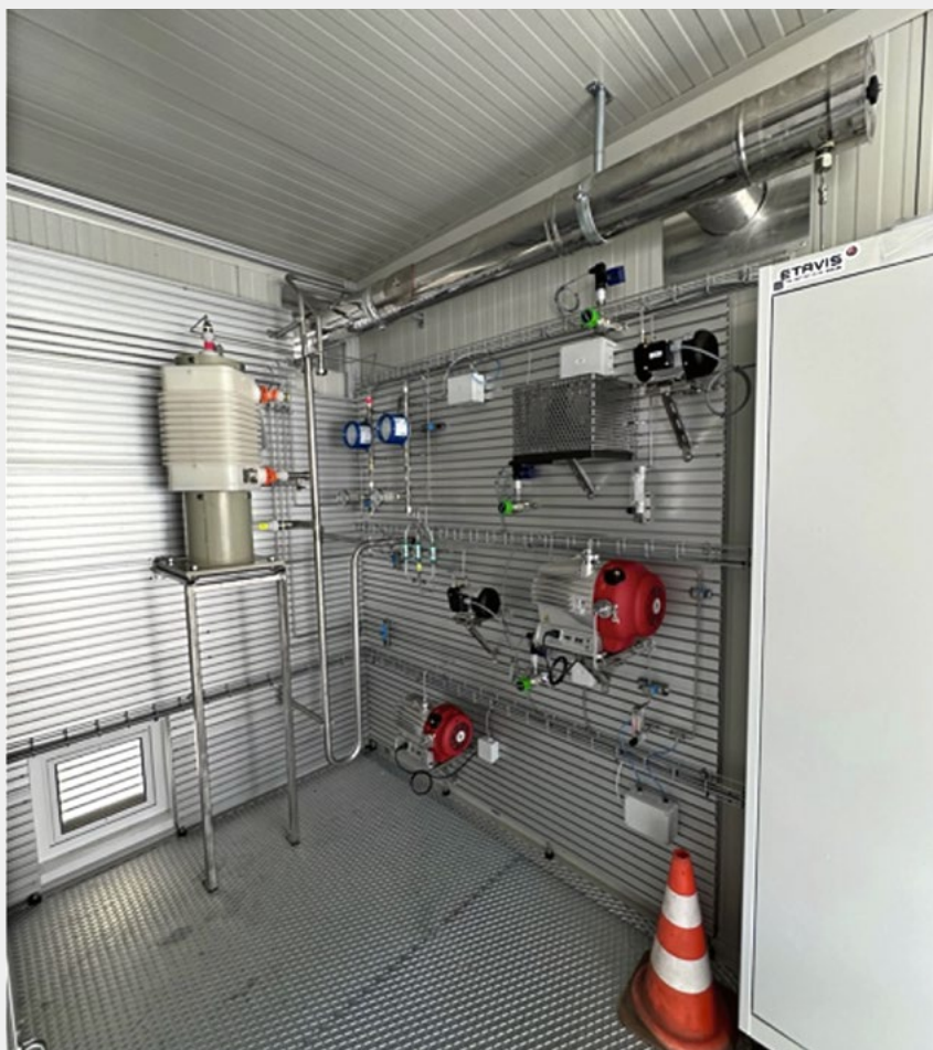
Fig. 8 Installation d'une membrane en graphène dans l'un des containers de l'Innovation Lab de Gaznat à Aigle, dans le cadre du projet énergétique GreenGas.
