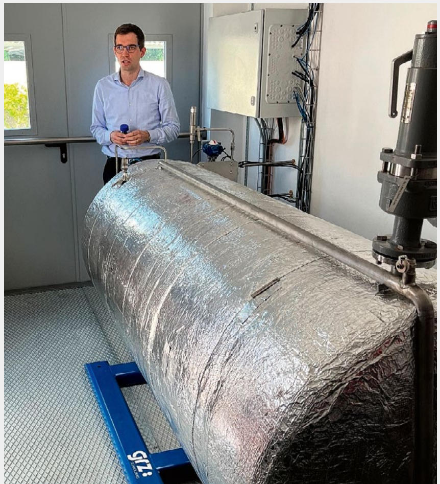
Fig. 2 Système à hydrure métallique pour le stockage du H 2 produit par électrolyse de l'eau.
