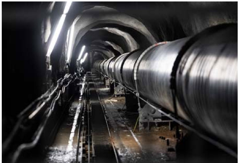
La Suisse ne dispose pas de stockage physique de gaz. Des gazoducs (photo) permettent de l'importer depuis les réserves de nos voisins. Gaznat se charge de cet approvisionnement pour la Suisse romande. KEYSTONE/SCHNEIDER
